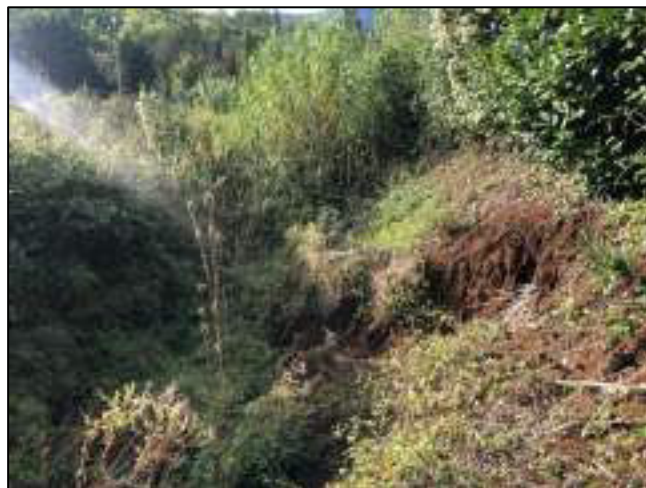
Nicchia di distacco relativa ad un pregresso fenomeno franoso
