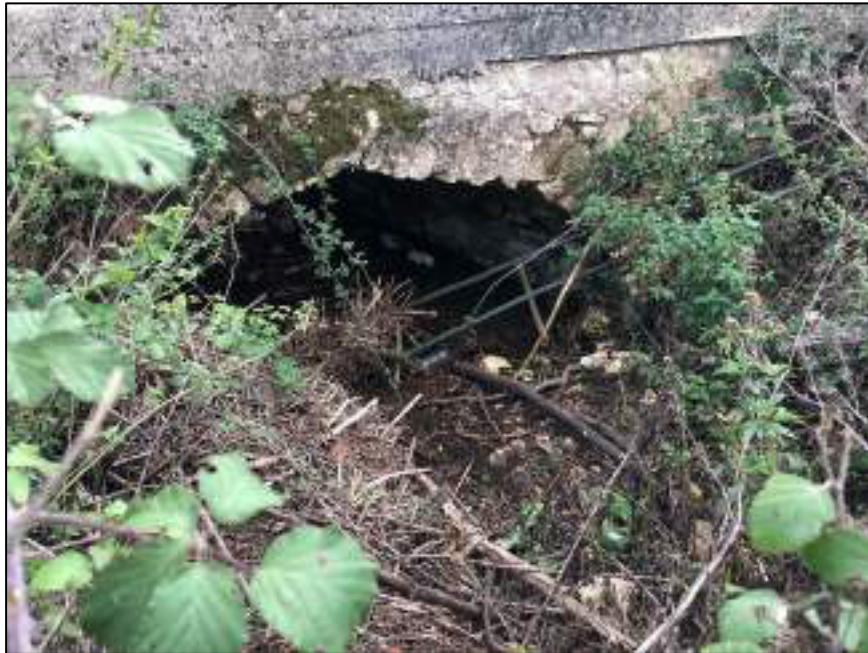
Accumulo di materiale detritico vegetale ed antropico in Loc. Pantano
